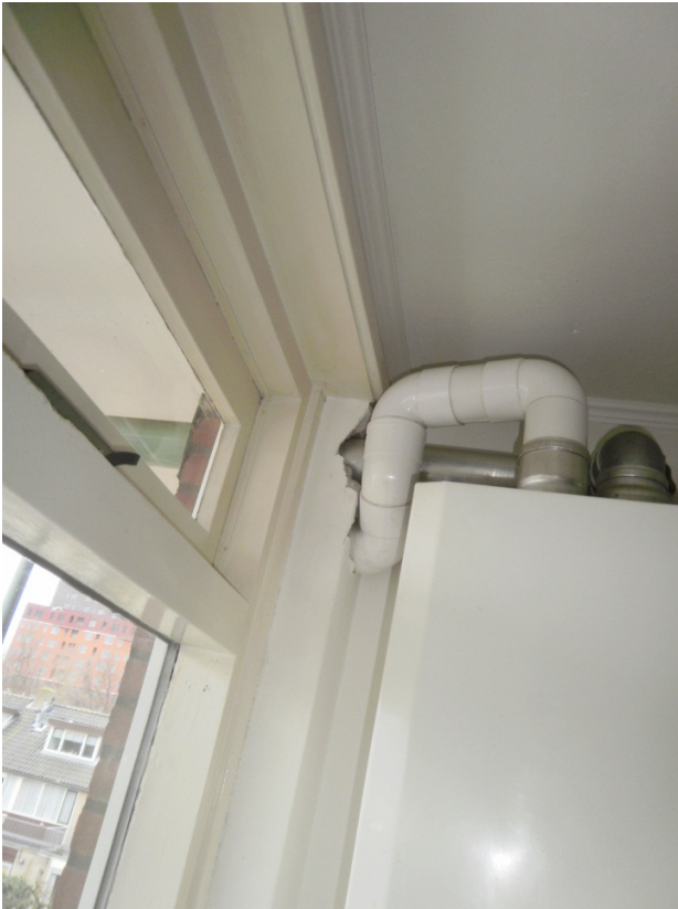
slordige afwerking na het plaatsen van de nieuwe combiketel
