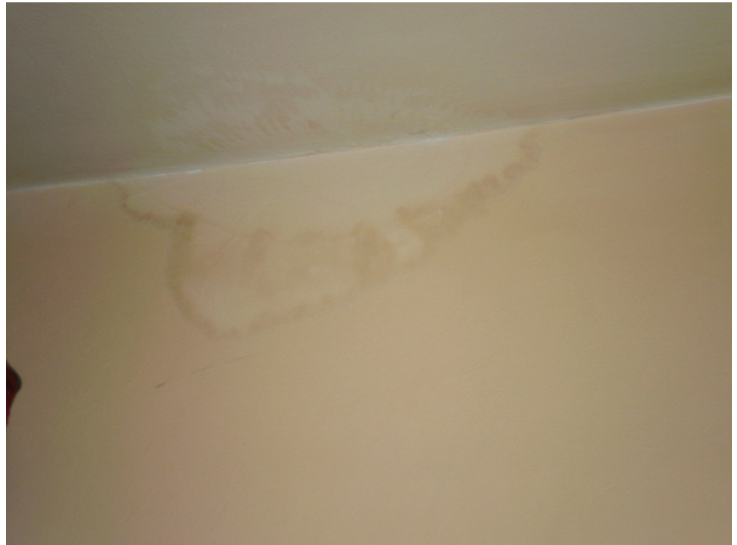
Vlekken ontstaan door water
