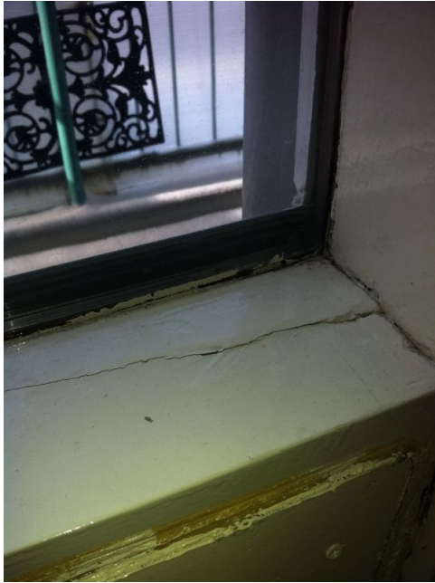
Scheur in kozijn
