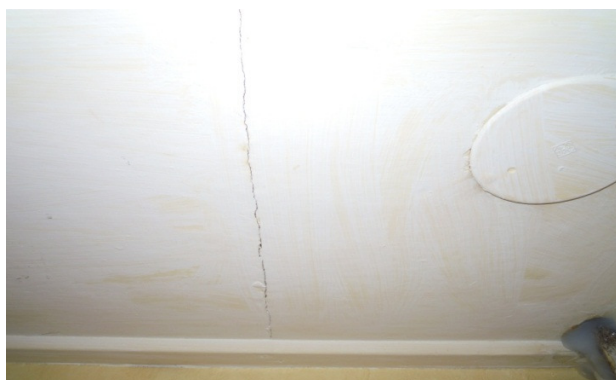
Zelfs scheuren in de muur in de kast van de woonkamer
